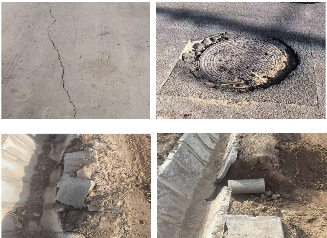
图4-1 部分实施现场损坏情况图片
